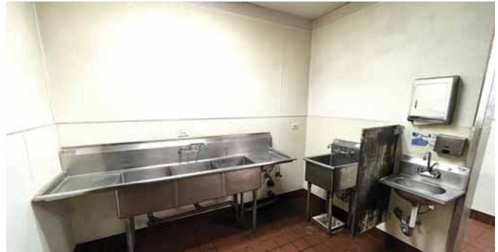
1182 N. Capitol Ave - Stainless Steel Sinks
