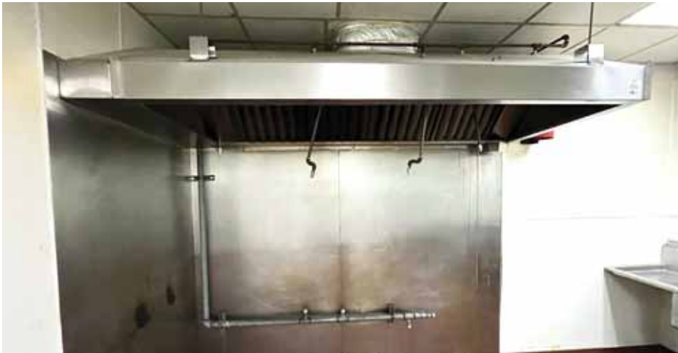
1182 N. Capitol Ave - Stainless Steel Exhaust Hood
