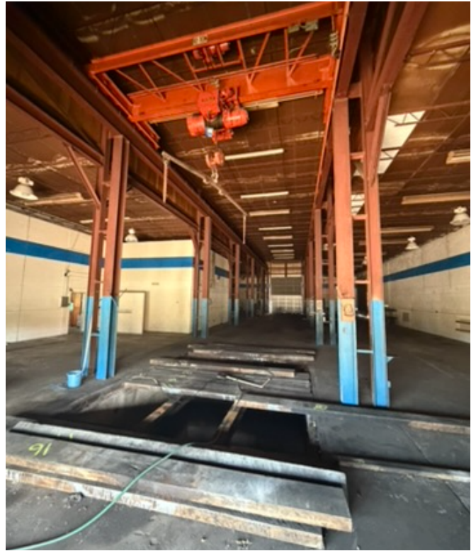
10 TON BRIDGE CRANE
