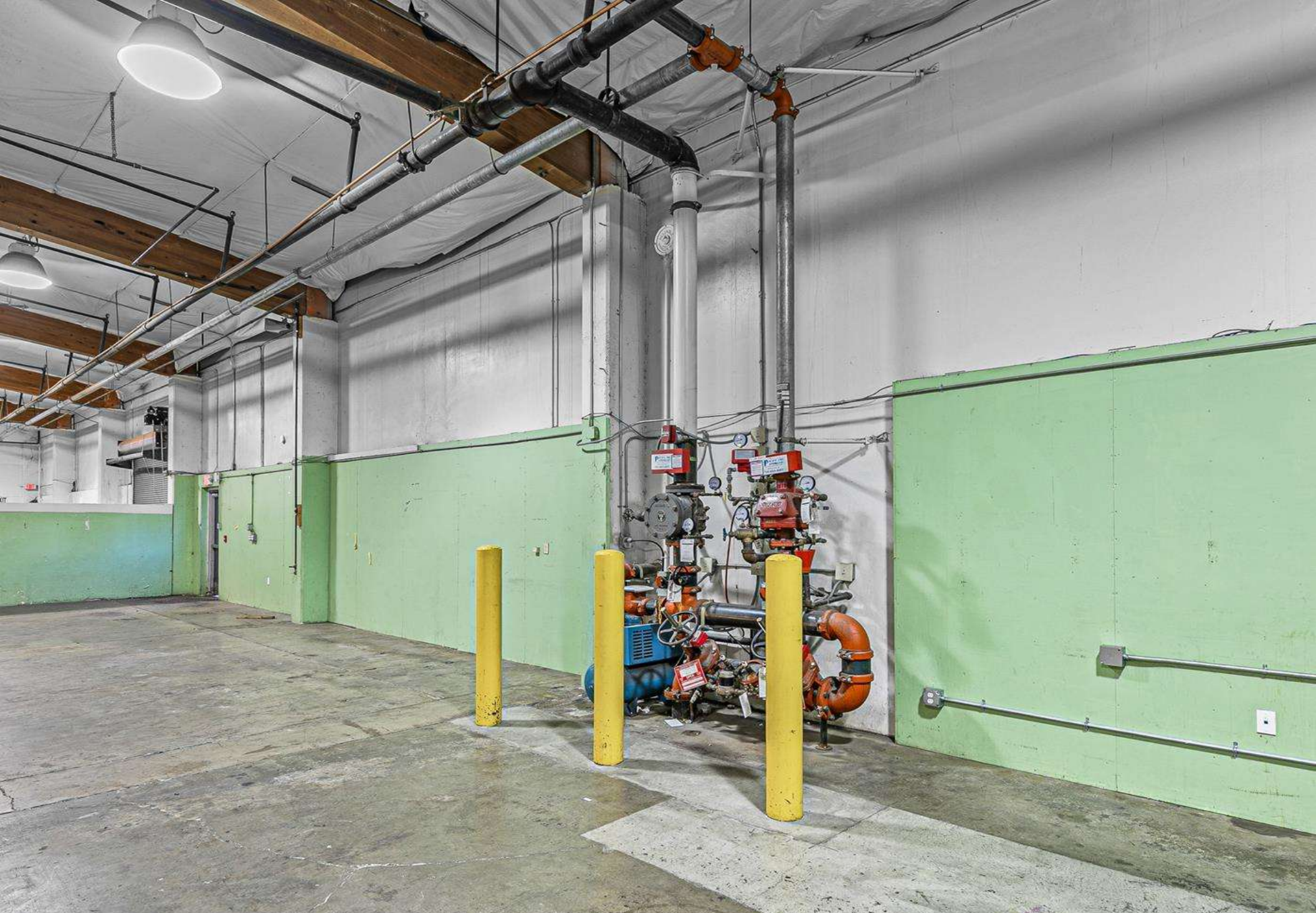
Fire Sprinkler Riser
