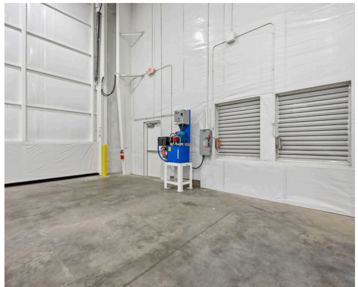
DOOR POWER UNIT & VENTILATION
