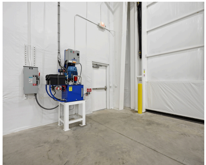
DOOR POWER UNIT & VENTILATION
