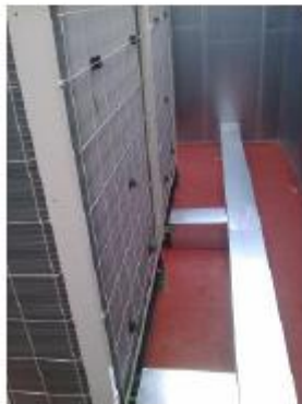
MÁQUINA CON SALIDA DE TUBERÍAS HACIA PATIO DENTRO DE CANALETAS
