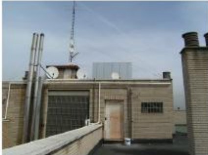
CAJETÓN ACCESO PLANTA DE CUBIERTA CON MÁQUINA INSTALADA ENCIMA
