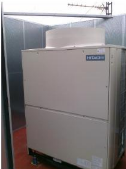
MÁQUINA ACTUAL DENTRO DEL CERRAMIENTO ACÚSTICO
